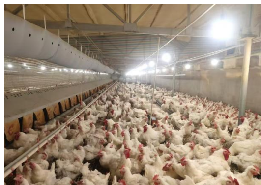
装有新风风管的平养鸡舍
